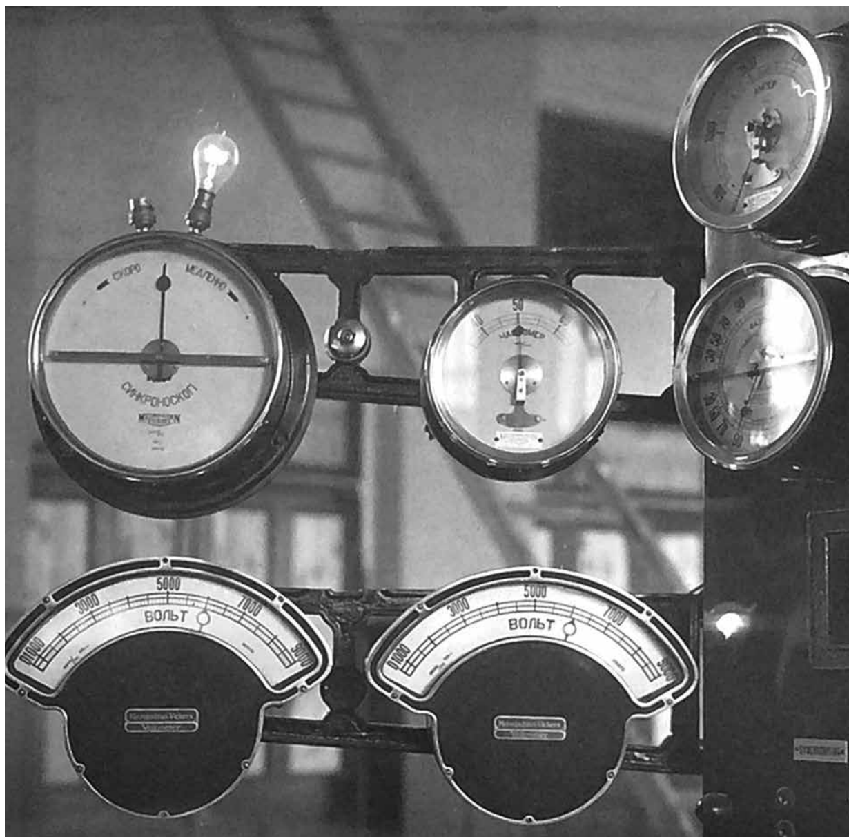
Распределительный щит Шатурской ГРЭС.
