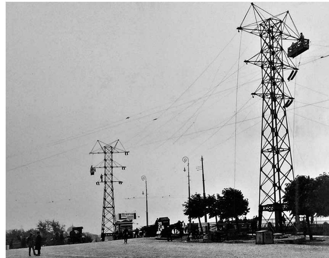
Подвеска проводов на электролинии Шатура – Москва.
