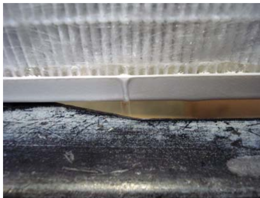
Рис. 4.37. Течь воды через стык фильтровального материала и рамки фильтра E11–31/38
