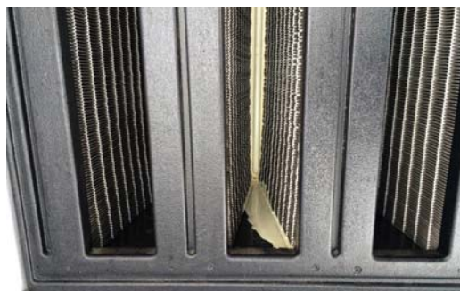
Рис. 4.48. Некачественная герметизация и ее отсутствие в стыках фильтровального материала с рамкой в V-образных секциях кассетных фильтров
