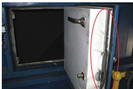
Рис. 2.65. Подсос грязного воздуха из машинного зала в воздуховод к ГТУ
