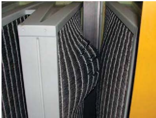
Рис. 3.103. Разрушение ФТО компании E
