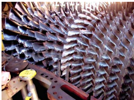
Рис.1.9. Повреждение лопаток осевого компрессора ГТУ ( https://goo.su/QHo11 )
