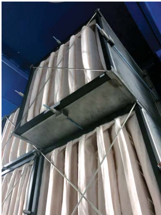
Рис. 4.13. Бокс для установки фильтров средней и тонкой очистки воздуха и датчиков давления
