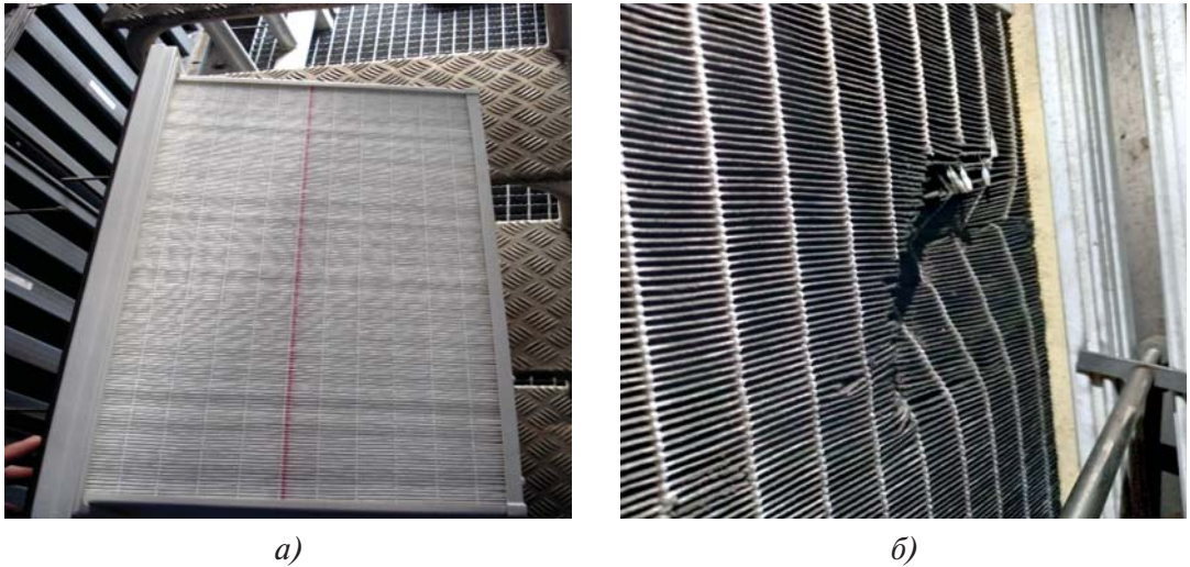
Рис. 3.81. Реверсная установка ФТО F8 защитная сетка отсутствует: а) перед установкой в КВОУ; б) в процессе эксплуатации повреждение фильтровального материала
