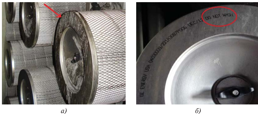
Рис. 3.8. Сургутской ГРЭС-2: а) подтеки влаги; б) предупреждение «НЕ МЫТЬ» [6]
