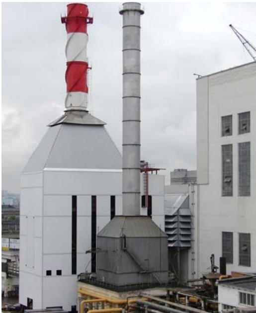
Рис. 2.37. КВОУ ГТУ ТЭЦ перед стеной котла-утилизатора ( https://clck.ru/33XTga )
